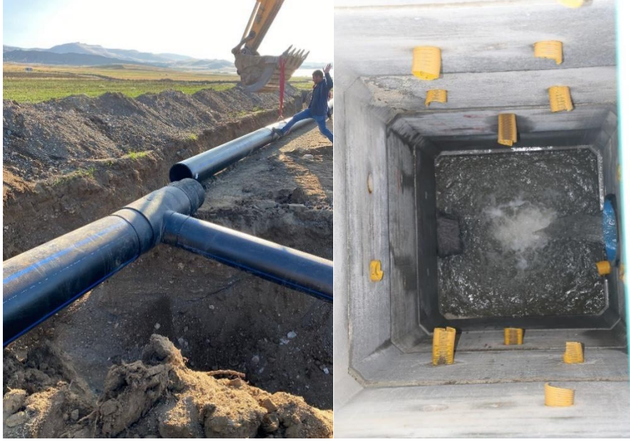
Görsel 4. Irgat Barajı Boru İletim Hattı ve Keson Kuyu
